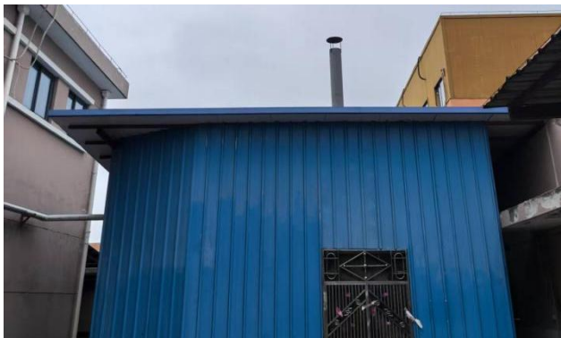
天然气燃烧废气排气筒
