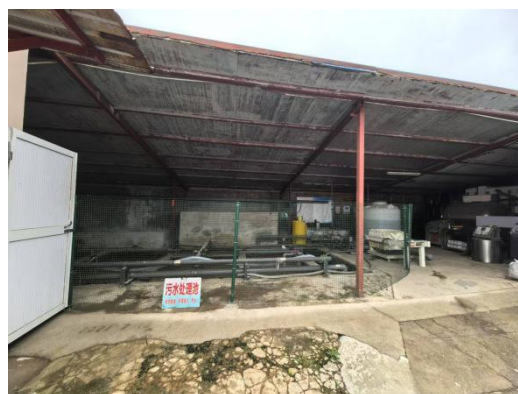
污水处理站照片
